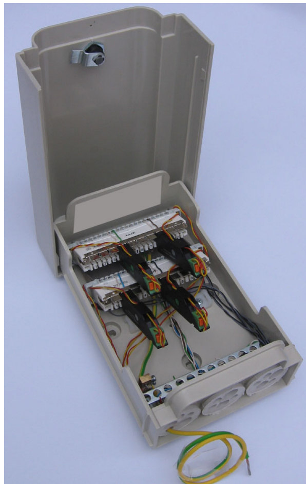
Sl 5 : Prikaz montiranih jednoparičnih splitera u kutiji za vazdušni razvod
